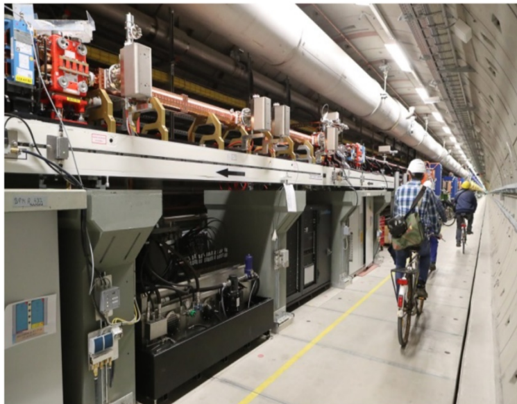
Рис. 2.4 – Система TDS BC2 в ускорительном тоннеле XFEL
