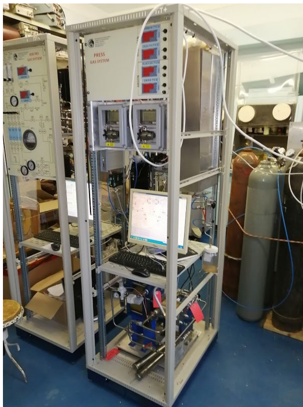
Рис. 18.7 – Газовая система, смонтированная в стойке
