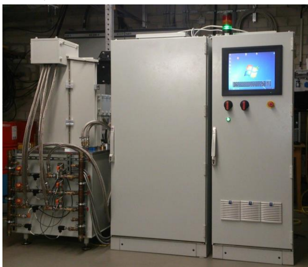
Рис. 2.1 – Система питания большой мощности HPRF INJ
