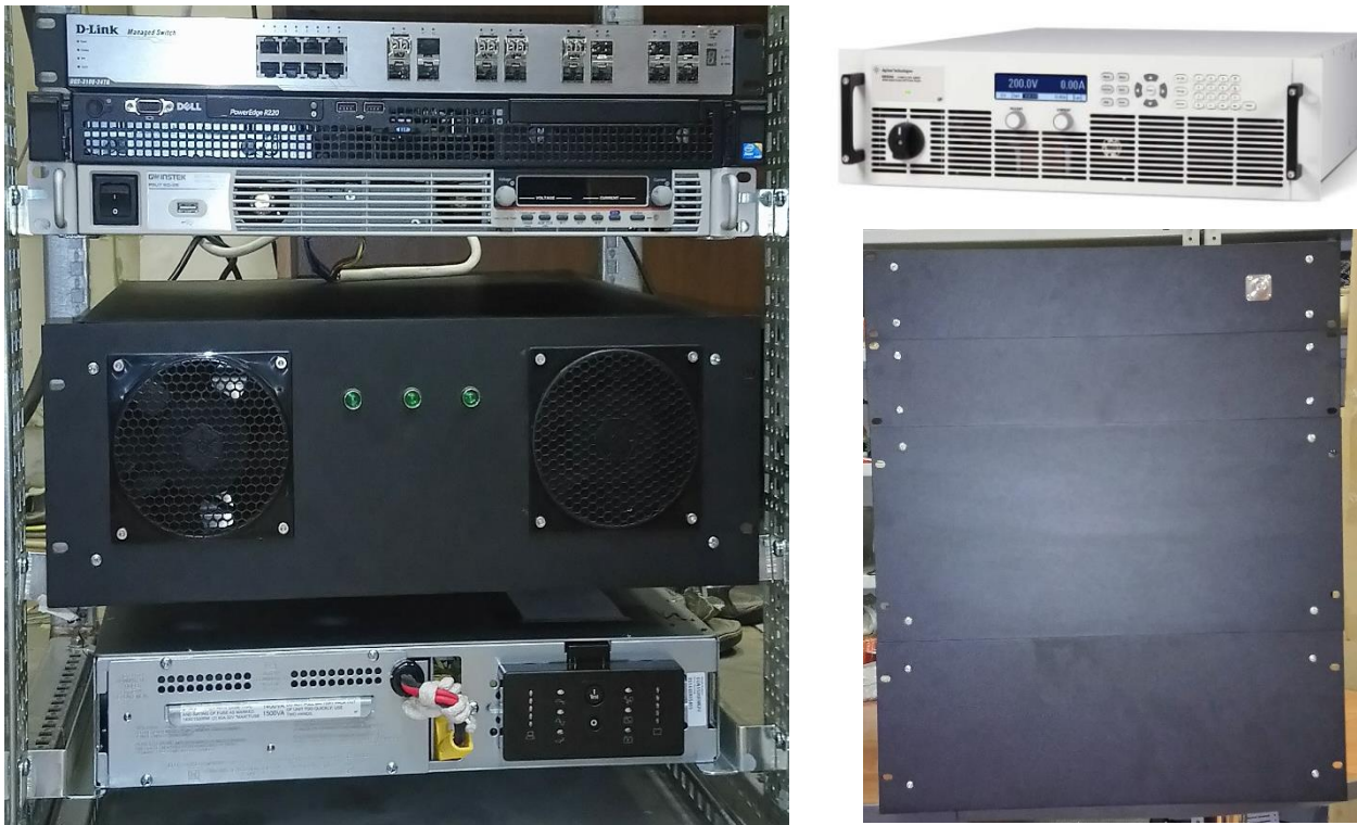
Рис. 2.7 – Оборудование питания и управления
