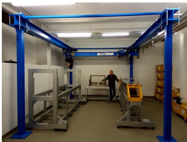
Рис. 16.27 - Общий вид участка с грузоподъёмными и транспортными приспособлениями
